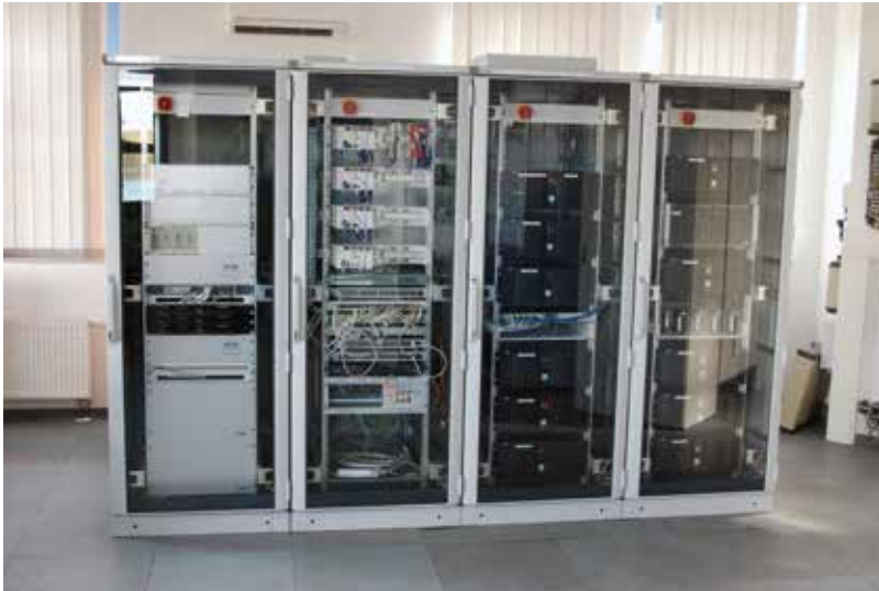
Ein Technikschränk der Leitzentrale Rothensee
